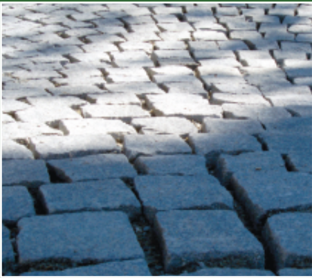
Pflasterfläche mit ausgewaschenen Fugenmaterialien, ca. 1 Jahr nach dem Neubau
